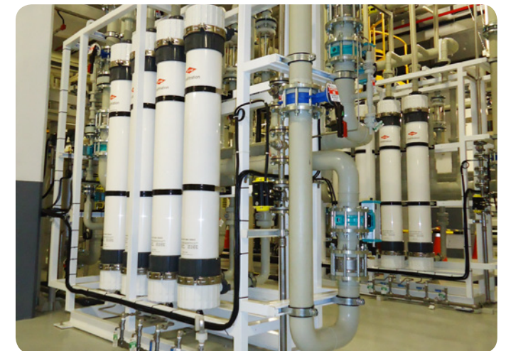
先進的廢水回收設備，減少能資源消耗與廢棄物產生
