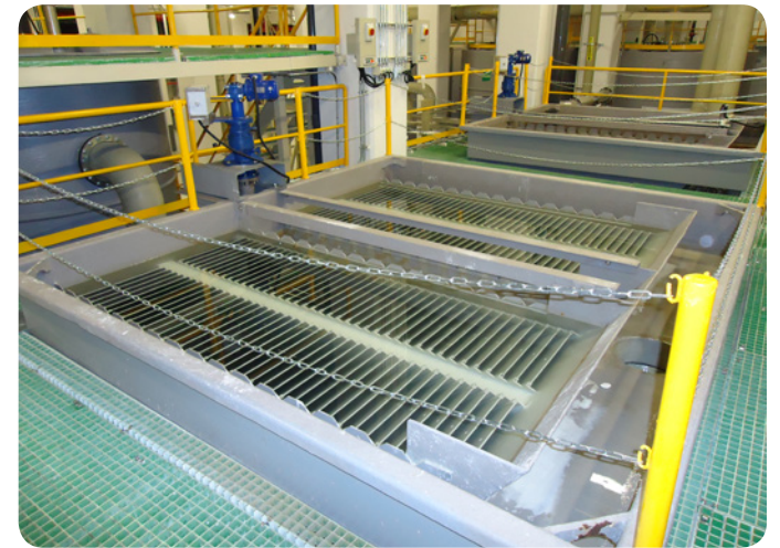
污水處理設備，提升放流水品質
