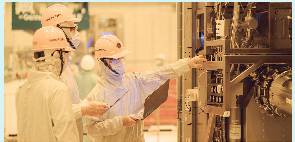
台積公司透過大數據分析手法及機台改善，成功提升 5% EUV 機台整體能源使用效率
